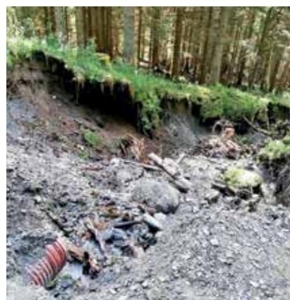
Konzentrierter Abfluss kann Erosionsrinnen bilden.
